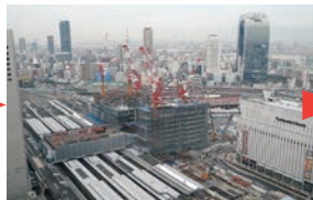
2009. 冬 橋上駅（南北連絡橋）の鉄骨がアークシティ大阪には到達しており、ノースゲートビルの鉄骨も次第に高く組み上がってきています。
